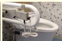
トイレ：呼出し
